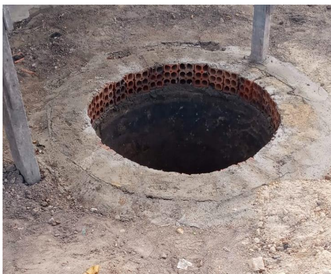
Figura 6: Fossa no Peri Peri, Boca da Mata /AL.
