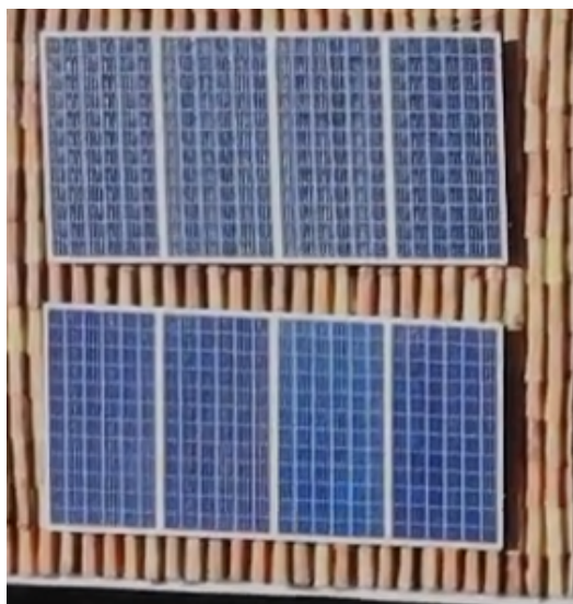
Figura 24 - Disposição dos painéis solares
