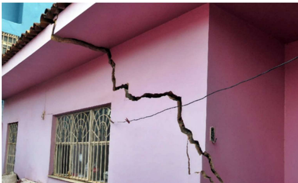
Figura 2: casa com rachadura
