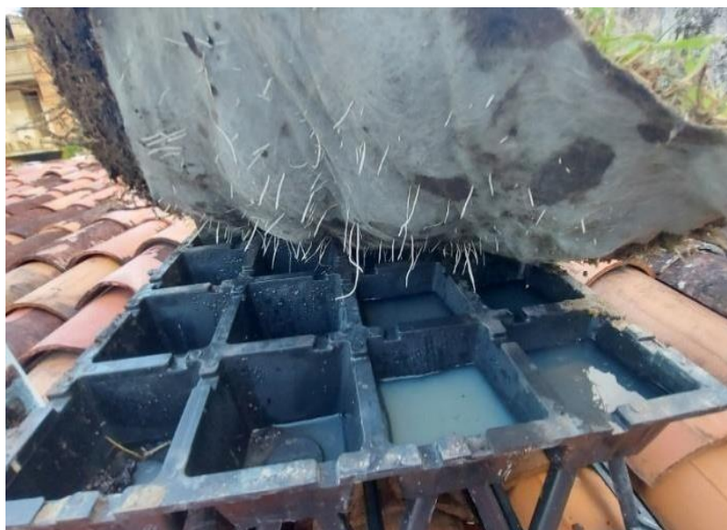
Figura 12 - Acúmulo de água na amostra do Pinheiro
