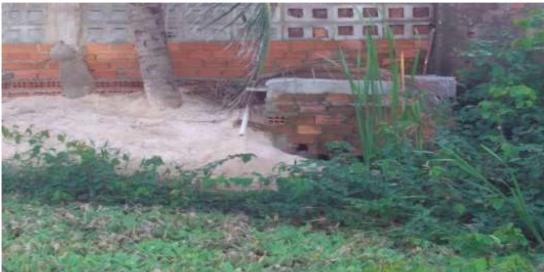
Foto 2 – Lançamento de esgoto a céu aberto.
