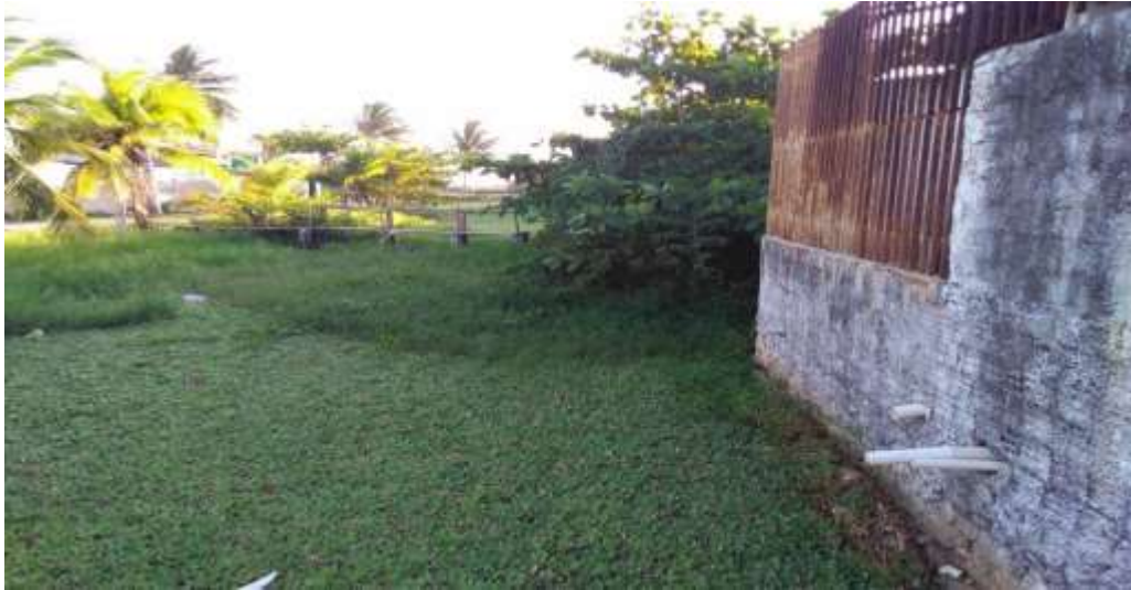
Foto 1 - Lançamento de esgoto a céu aberto.
