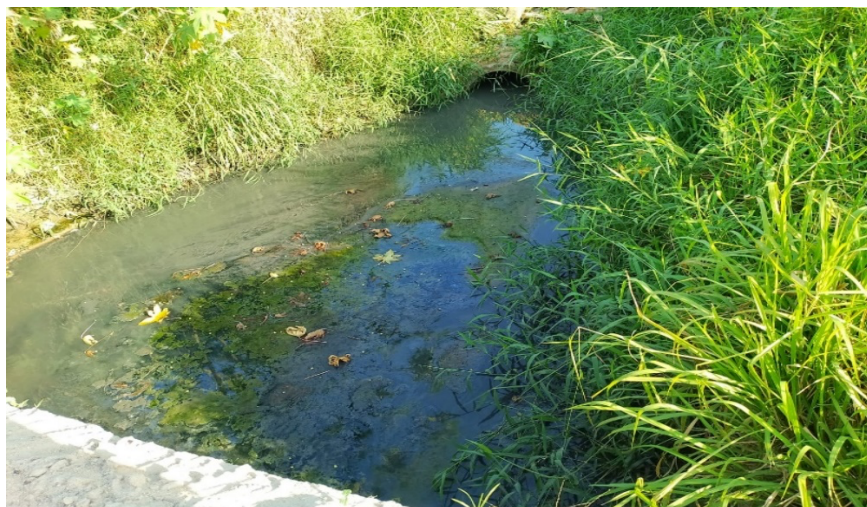
Figura 13- Bueira que sai o esgoto localizada Thiago Sarmento
