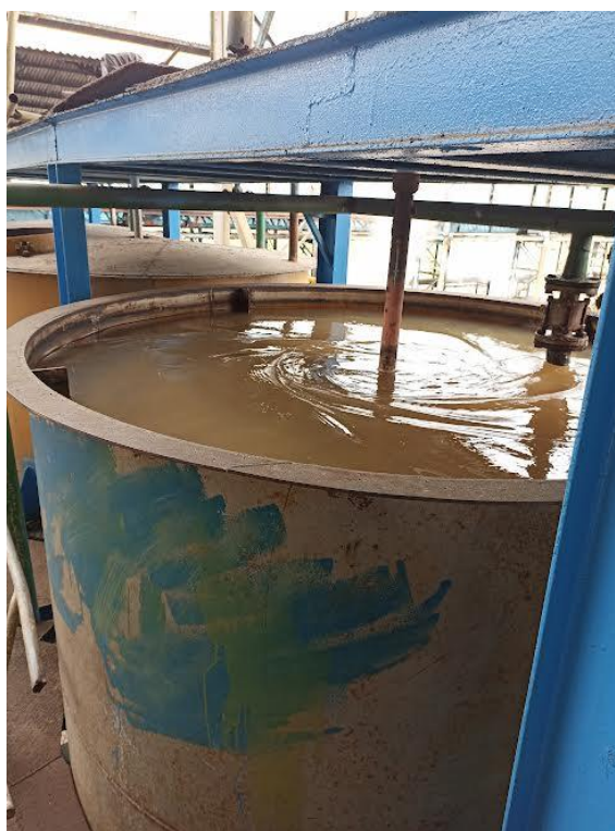
Figura 18: Tanque de preparo de floculante (polímero).
