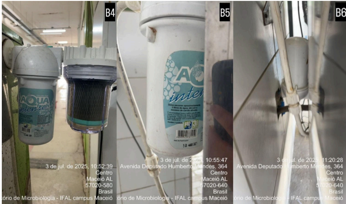
Figura 16 - Condições dos filtros dos bebedouros (B04, B05 e B06) no levantamento inicial (julho/2025).
