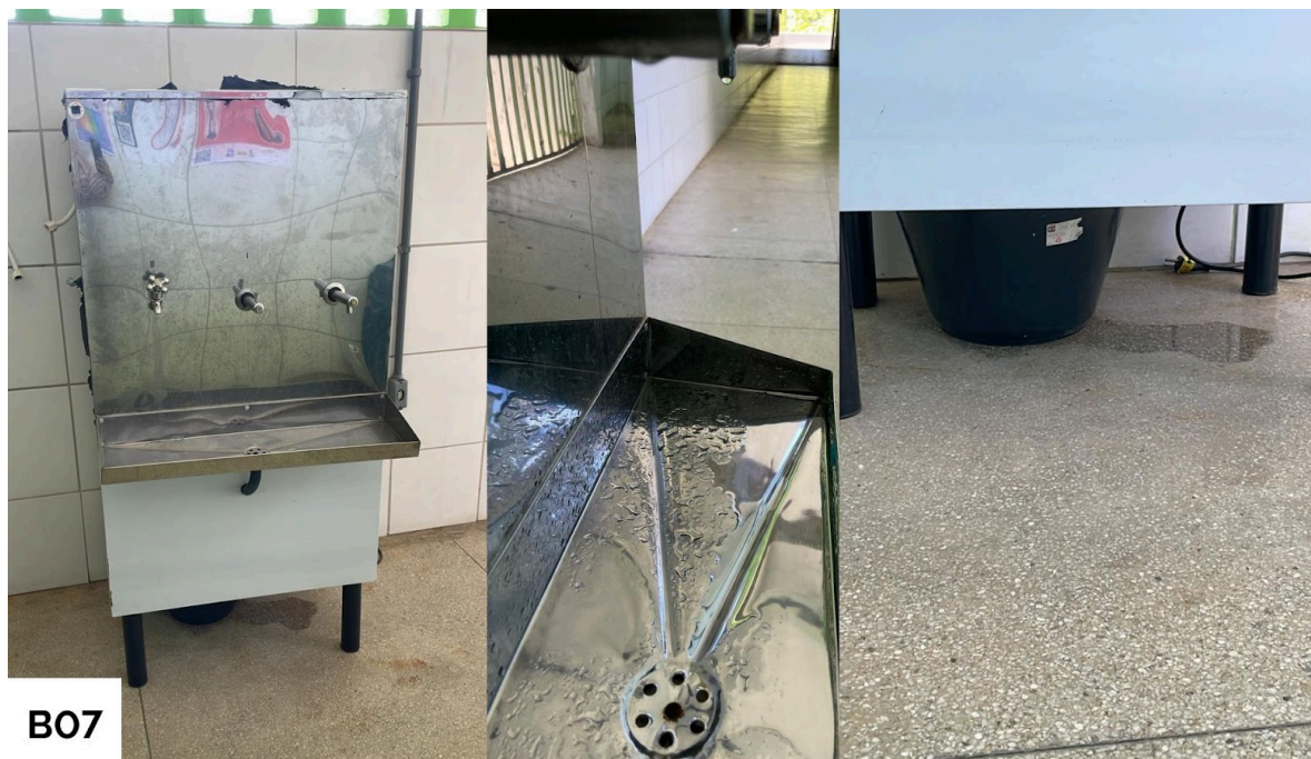
Figura 14 - Condições externas do bebedouro B07 - 1º pavimento
