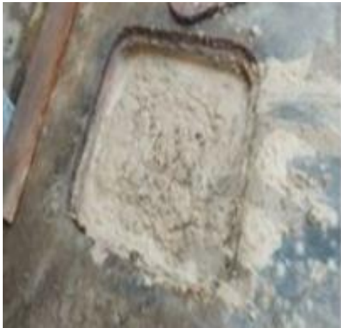
Figura 22 – Caixa de Gordura de um imóvel na Av. Doutor Antônio Gomes de Barros
