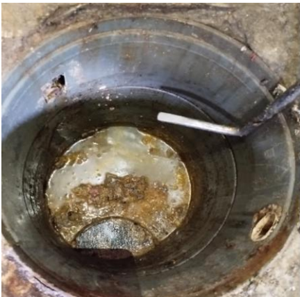
Figura 27 – Caixa de gordura fora dos padrões na NBR 8160
