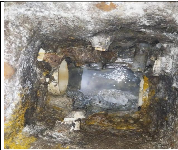
Foto 01: Caixa de Inspeção (CI) a montante do local de estudo
