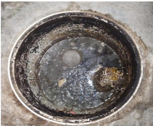
Figura 25 – Caixa de gordura subdimensionada na Av. Dr. Antônio Gomes de Barros
