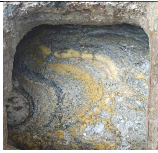
Foto 04: Caixa de Gordura sem sistema de contenção
