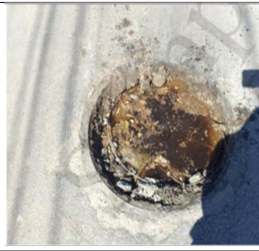
Foto 02: Caixa de Inspeção (CI)
