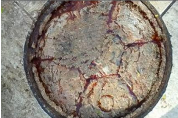
Figura 28 – Poço de visita da rede de esgoto na Av. Doutor Antônio Gomes de Barros
