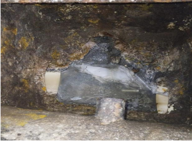
Figura 26 – Caixa de Inspeção obstruída na Av. Doutor Antônio Gomes de Barros
