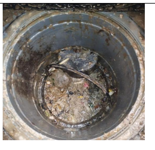
Foto 06: Caixa de Gordura
