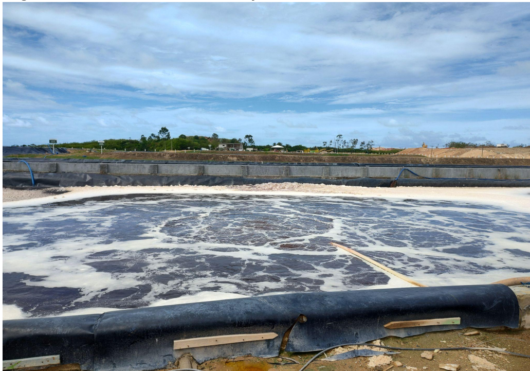
Figura 20 - Piscina de chorume na estação de tratamento de chorume do CTR de Maceió.
