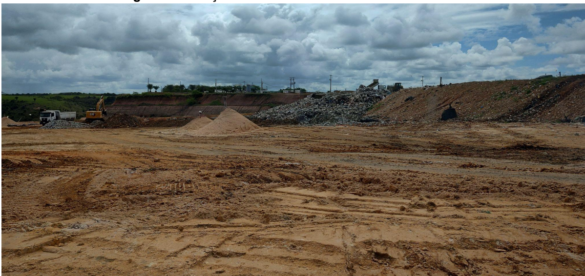
Figura 26 - Praça de tratamento de resíduos no CTR de Maceió.
