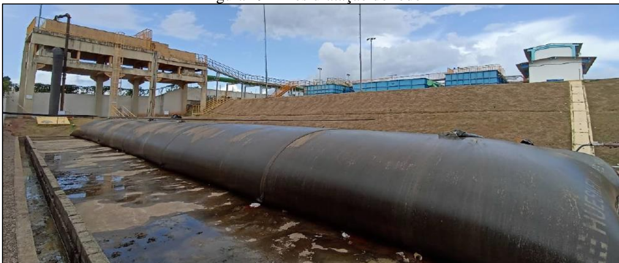
Figura 19 – Desidratação do lodo
