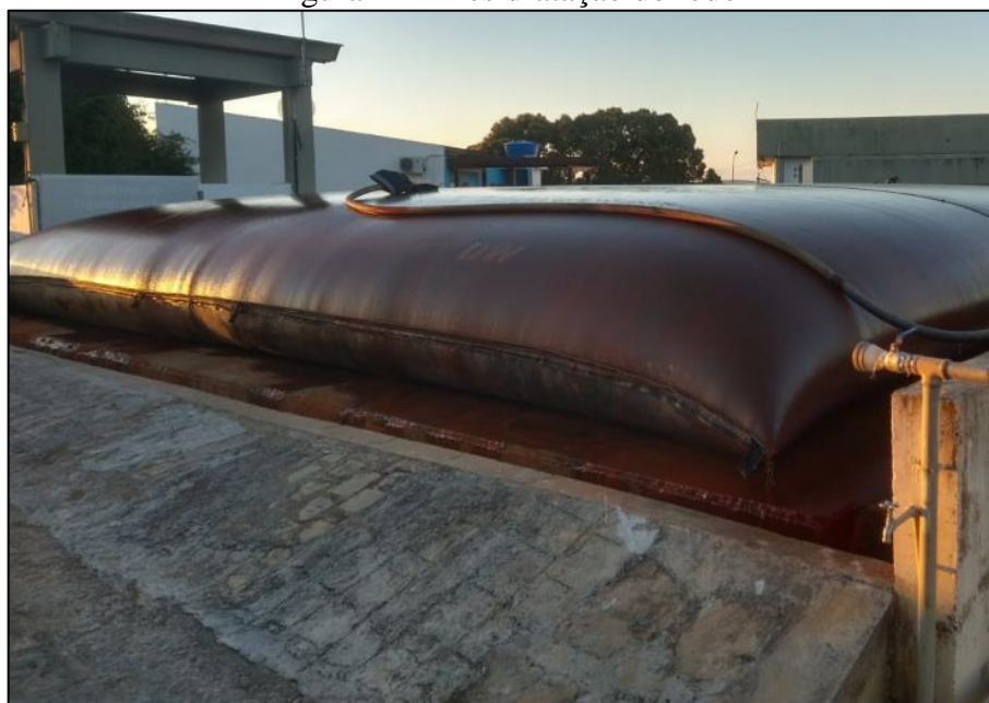
Figura 12 – Desidratação do lodo
