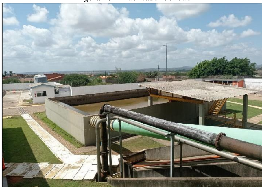
Figura 18 – Adensador de lodo
