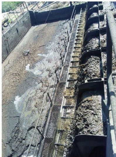
Figura 3: Tratamento de água da lavagem na usina.
