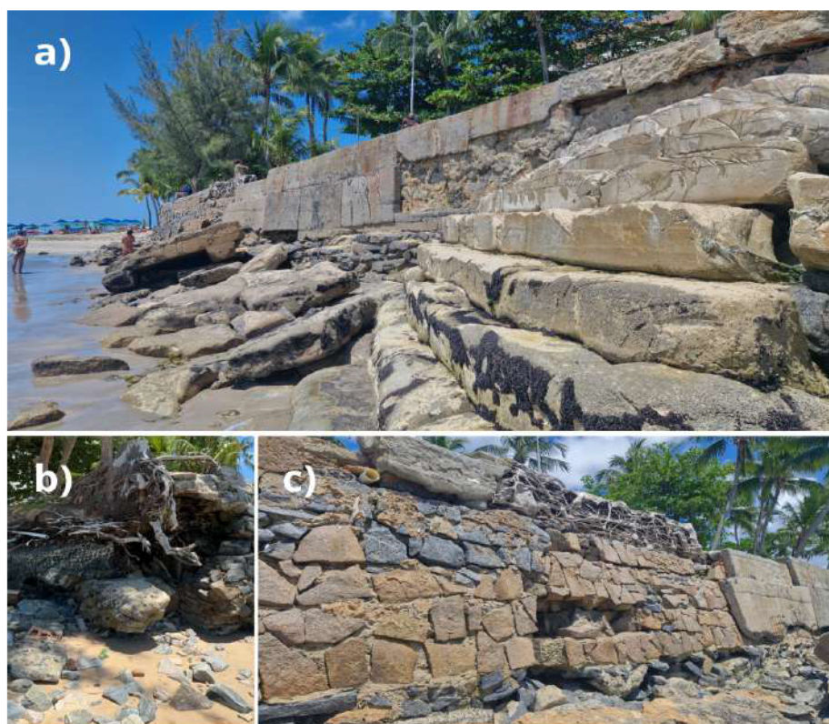
Figura 27 - a) Paredão de concreto ao lado da contenção; b) e c) raízes expostas.
