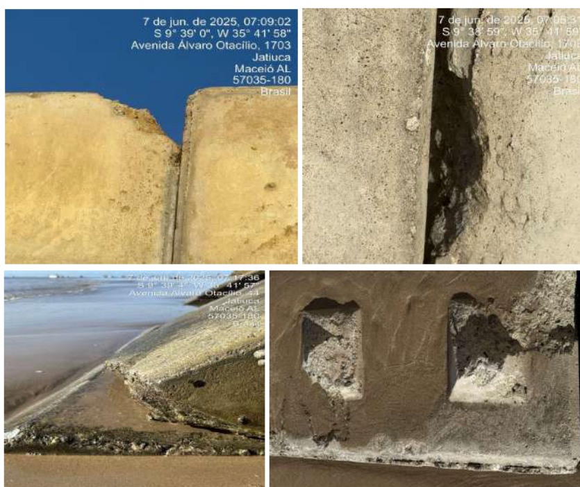
Figura 34 - Desgaste em obras de contenção com blocos de concreto.
