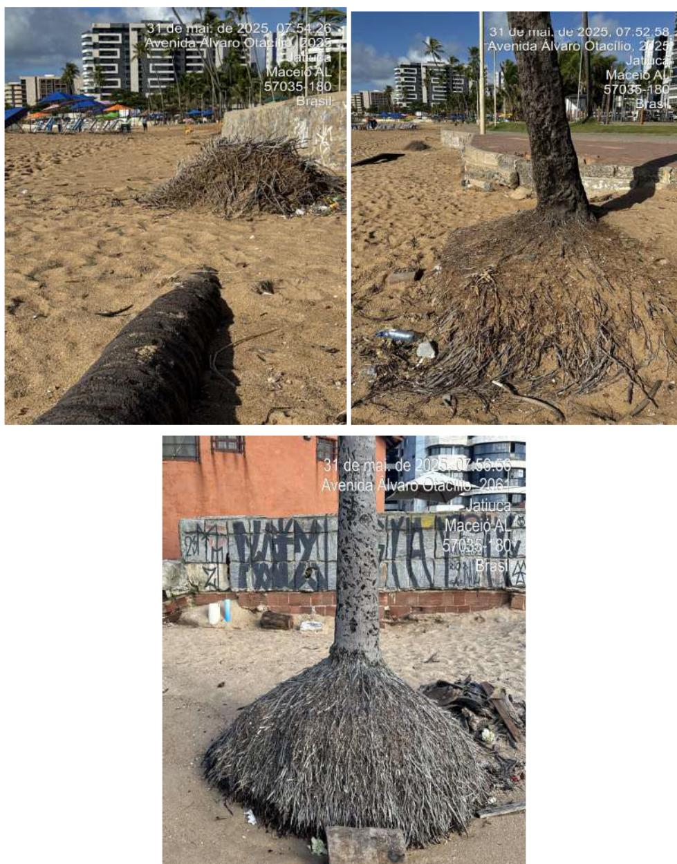
Figura 43 - Coqueiros com raízes expostas na praia de Jatiúca.
