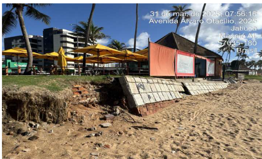
Figura 44 - Estrutura de estabelecimento comercial com sinais de instabilidade.
