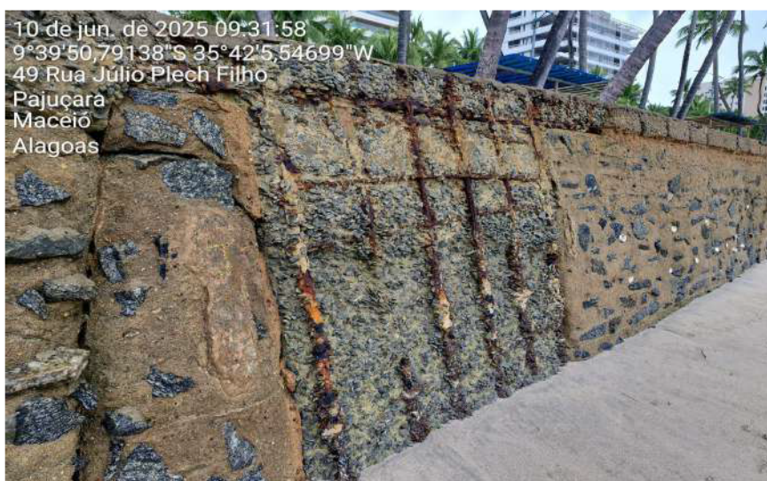
Figura 22 - Vigas expostas em parte do muro.
