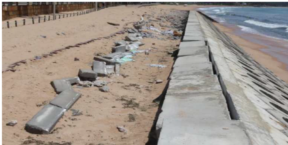
Figura 36 - Obra de contenção marítima próxima a Lagoa da Anta danificada pela força do mar em fevereiro de 2024.
