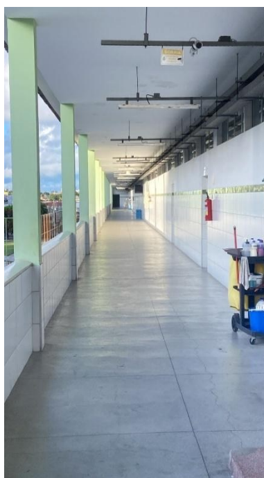
Figura 19 – Escada e corredor, ausência de iluminação de emergência em rotas de fuga.
