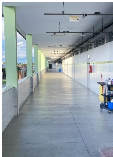
Figura 26 – Ausência de hidrantes e mangotinhos nos corredores
