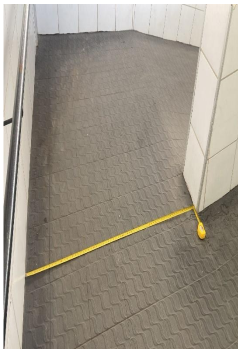
Figura 14 – Vãos da rampa nas saídas de emergência e suas condições.
