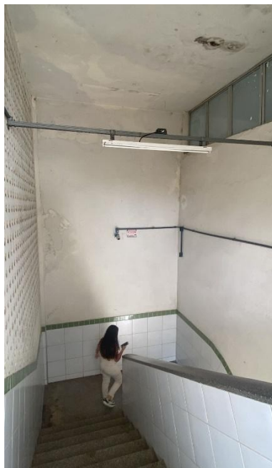
Figura 18 – Escada e corredor, ausência de iluminação de emergência em rotas de fuga.
