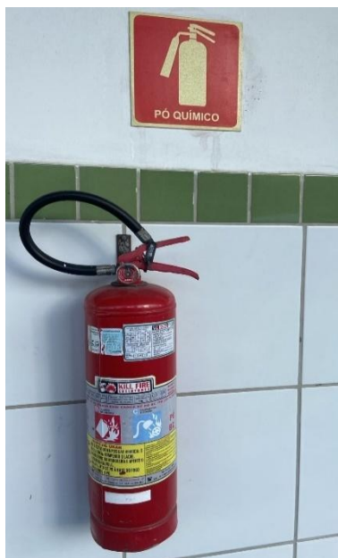
Figura 23 – Sinalização de Extintores.
