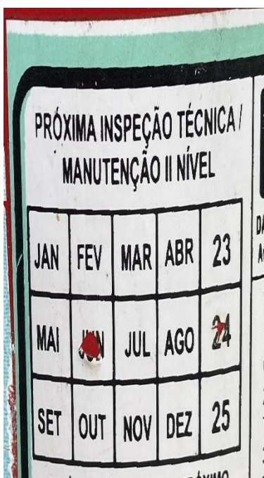
Figura 25 – Extintores, prazo de manutenção.
