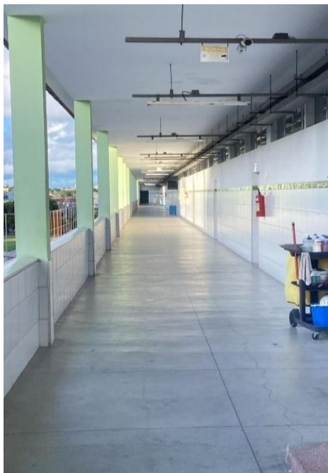
Figura 22 – Corredor das rotas de fuga sem presença de sistema de detecção e alarme.
