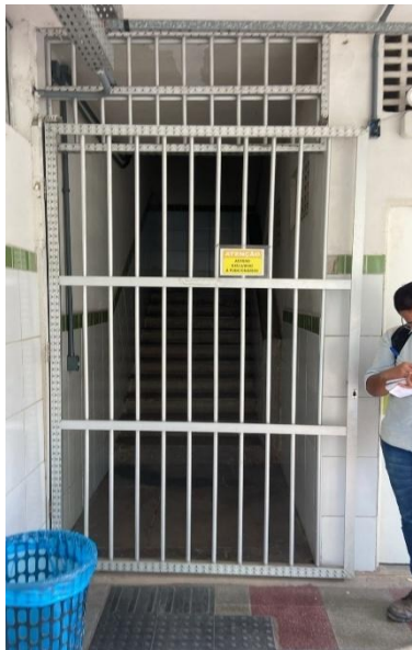
Figura 24 – saída de emergência, ausência de sinalização de saída de emergência.
