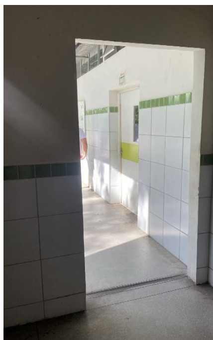
Figura 12 – Vãos de saídas de emergência.
