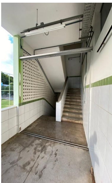
Figura 21 – Rampa e escada, ausência de iluminação de emergência em rotas de fuga.
