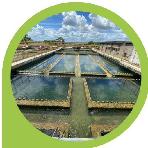
Figura 6 - Decantadores da ETA do Complexo Morro do Gaia
