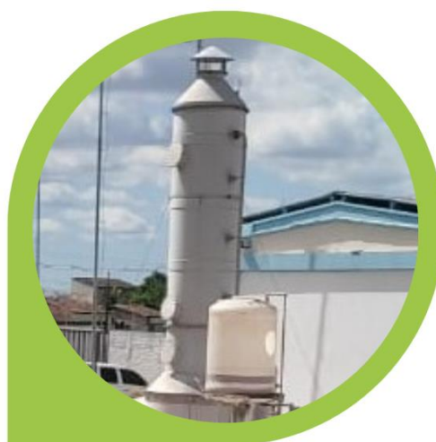
Figura 8 - Local de fabricação do hipoclorito de sódio
