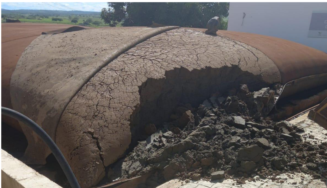
Figura 20 - Lodo em bag de desidratação da ETA da cidade de São Brás-AL
