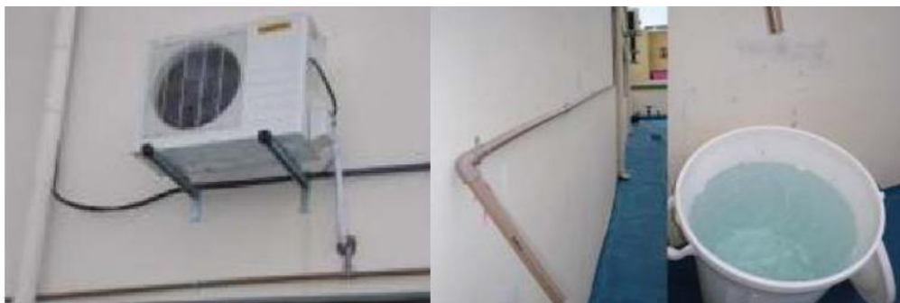
Figura 4. Conexão dos tubos de PVC e coleta de água dos drenos Fonte: Mota; Oliveira; Inada (2011)
