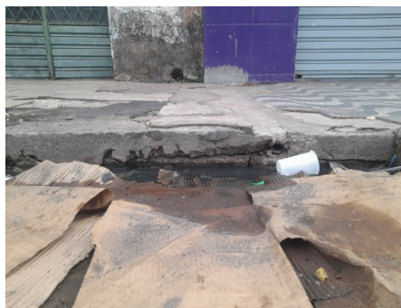
Figura 1: Esgoto e frestas na calçada da rua Santa Ana
