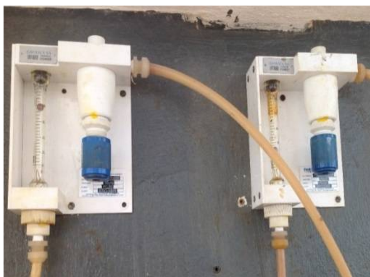
Figura 9 – Rotâmetro da ETA
