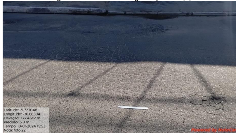
Figura 25 – Trinca interligada “jacaré” (J)
