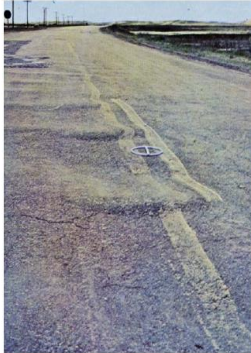
Figura 08 – Ondulação ou Corrugação
