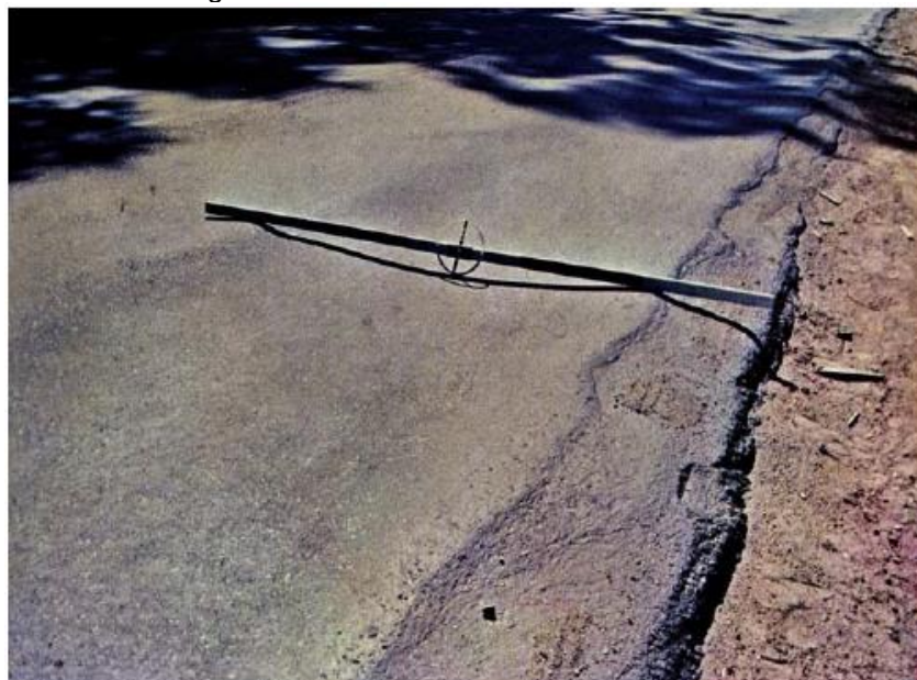
Figura 07 – Afundamento ou Trilho de Roda
