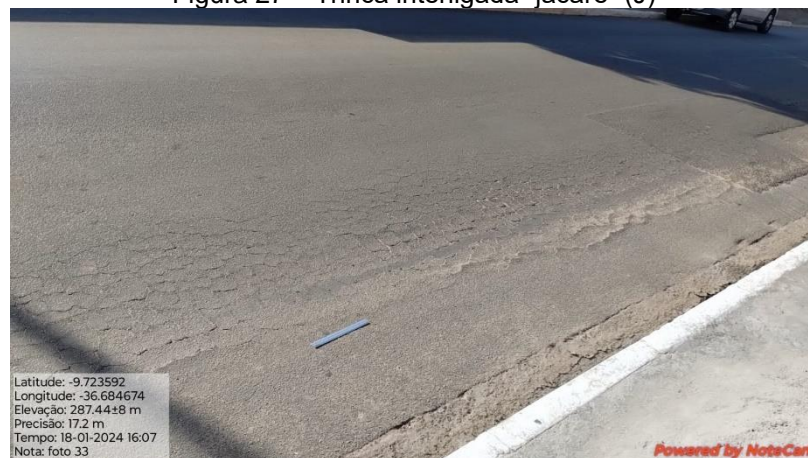
Figura 27 – Trinca interligada “jacaré” (J)
