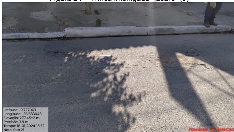
Figura 24 – Trinca interligada “jacaré” (J)
