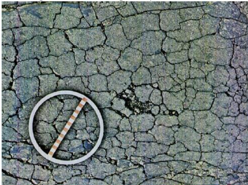
Figura 05 – Trinca interligada – tipo Couro de Jacaré
