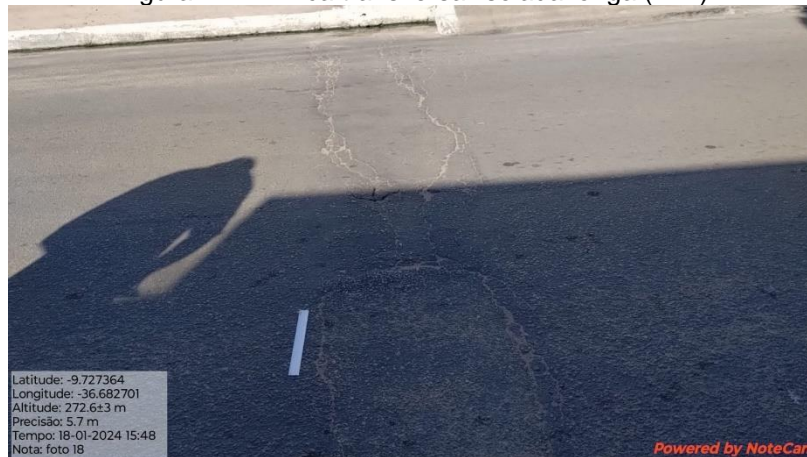
Figura 21 – Trinca transversal isolada longa (TTL)
