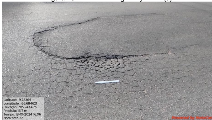
Figura 26 – Trinca interligada “jacaré” (J)
