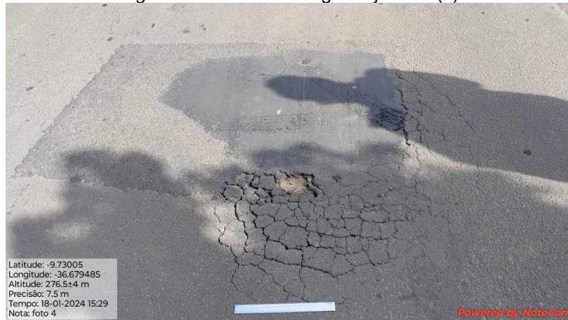
Figura 22 – Trinca interligada “jacaré” (J)
