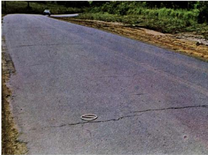
Figura 03 – Trinca isolada transversal
