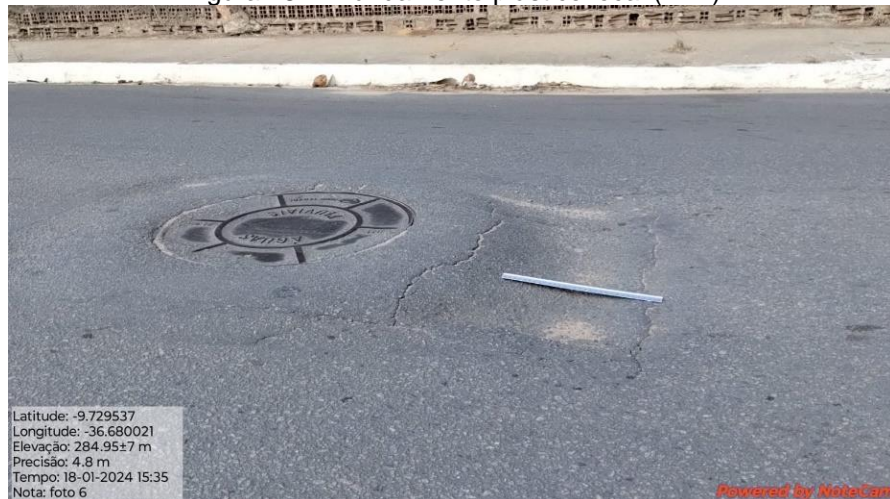
Figura 28 – Afundamento plástico local (ALP)
