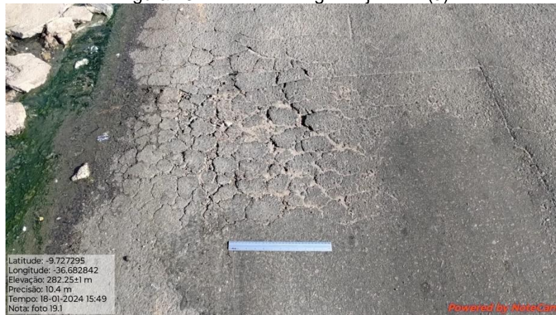
Figura 23 – Trinca interligada “jacaré” (J)
