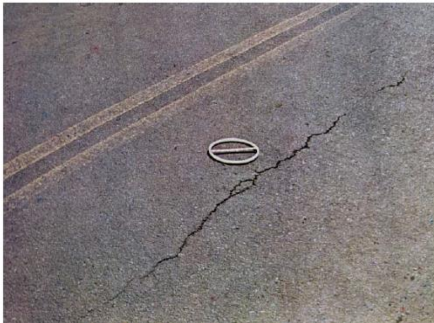
Figura 04 – Trinca isolada longitudinal
