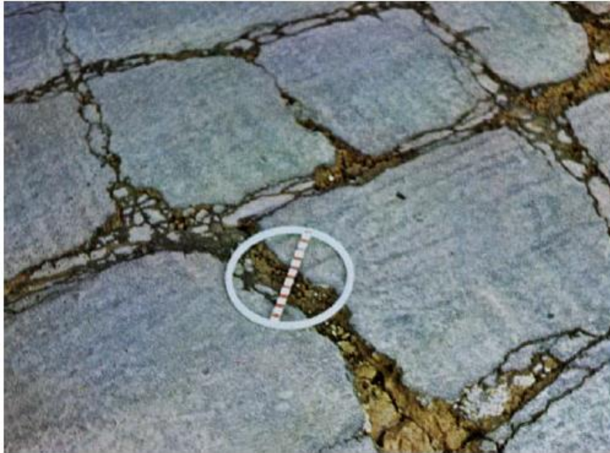
Figura 06 – Trinca interligada – tipo Bloco
