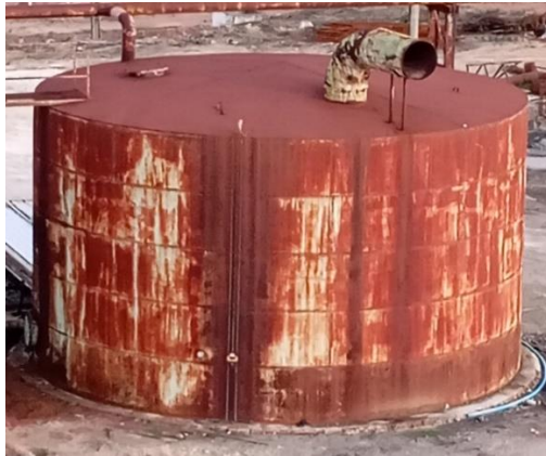
Figura 4 – Tanque de condensado.
