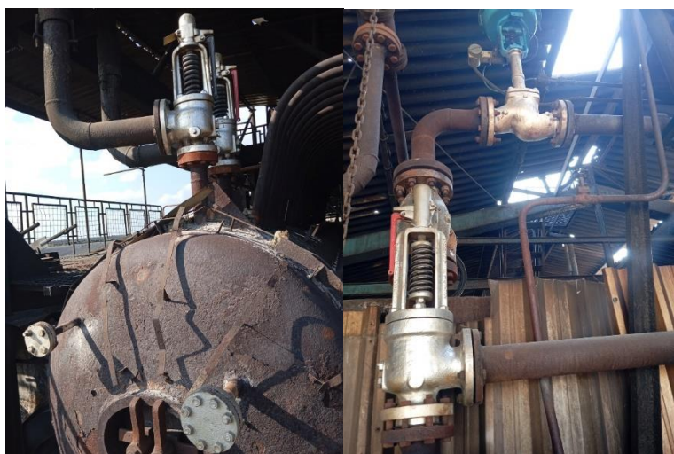
Figura 6 – Válvulas de segurança.
