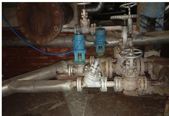
Figura 5 – Sistema de purga.
