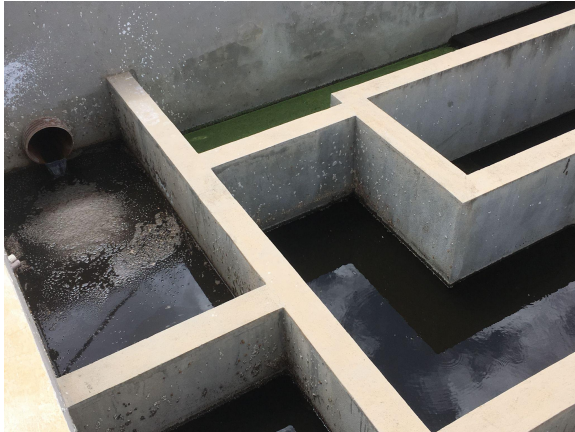
Figura 7: Entrada do tanque de cloração
