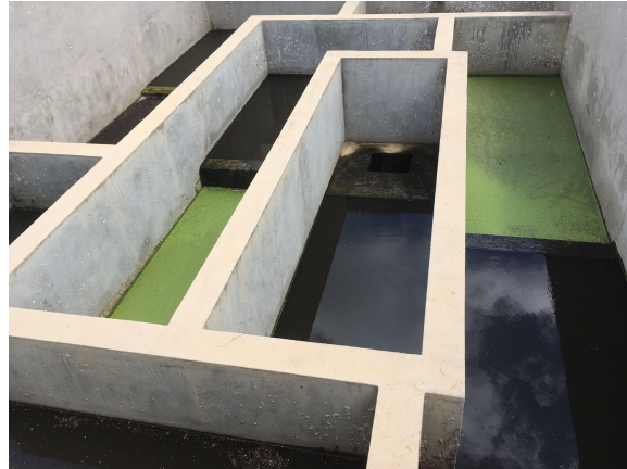
Figura 8: Saída do tanque de cloro (centro)
