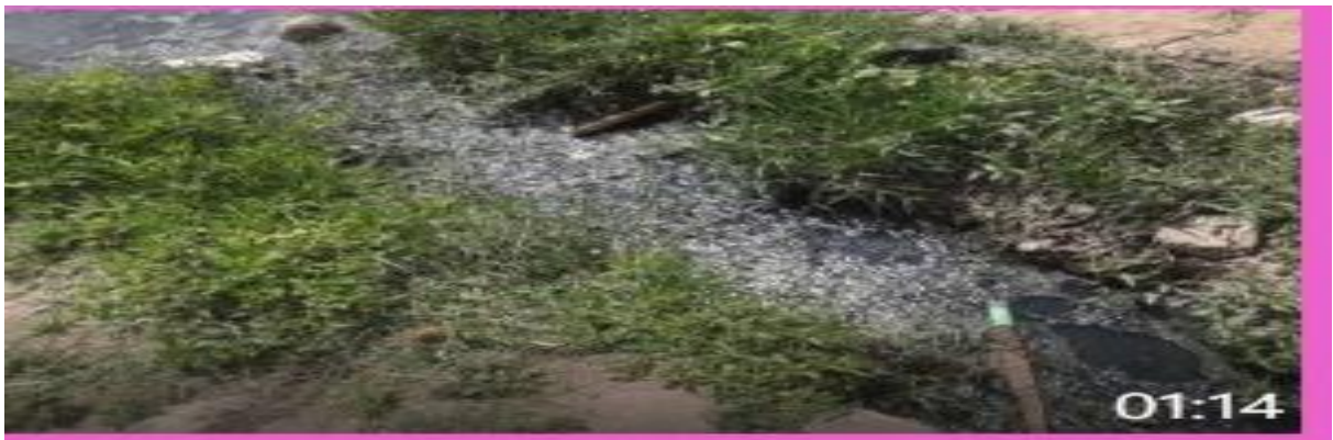
Figura 1 – Esgoto a céu aberto
