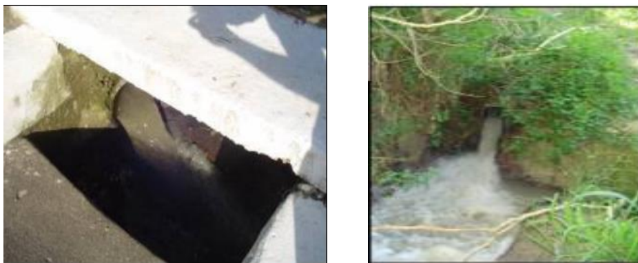
Figura 5: Esgoto sendo lançado na rede pluvial e sua saída na grota do Ouro Preto
