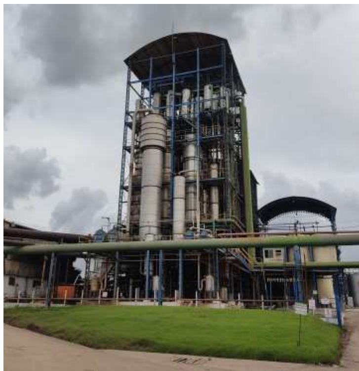
Figura 9 - Torre de destilação.
