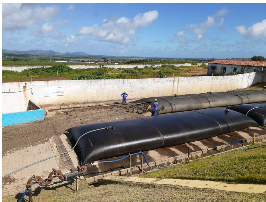
Figura 3. Manta geossintética Soiltain® DW em uso na ETA da Agreste Saneamento em Arapiraca/AL. Fonte: Autor.
